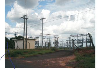
Substação COPEL - Companhia Paranaense de Energia Localização: Avenida Castelo Branco
