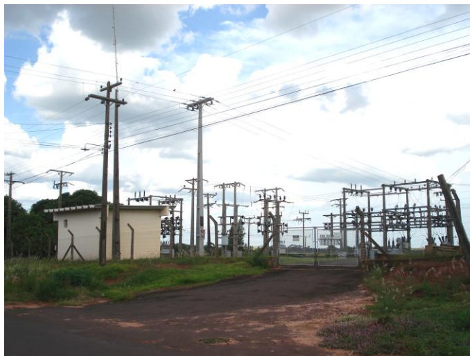
Fig. 6.4.2 - Subestação de Energia em Iporã
