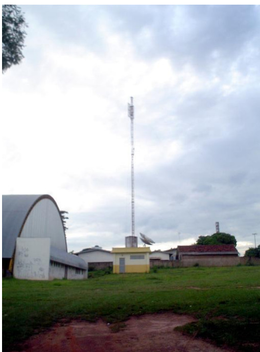
Fig. 6.5.6 - Torre repetidora da SBT
