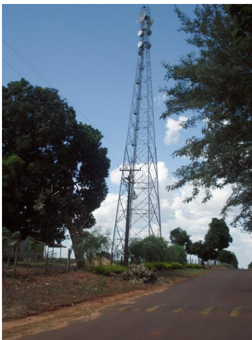
Fig. 6.5.4 - Torre repetidora localizada na Vila Iara
