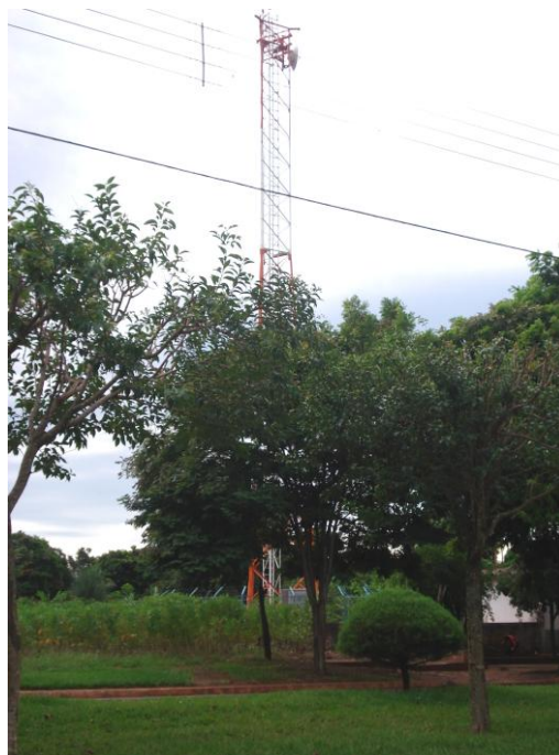
Fig. 6.5.2 - Torre de telefonia Brasil Telecom localizada na Vila Nilza
