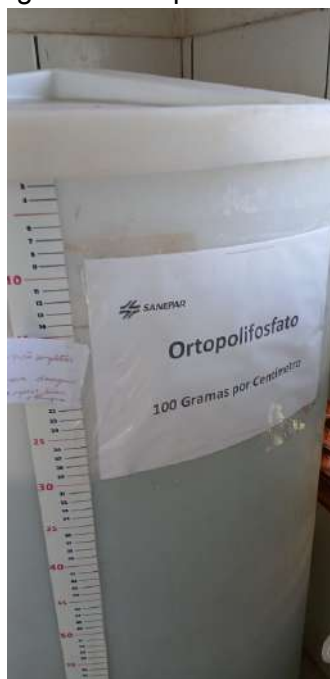
Figura 28 : Tanque de dosagem de ortopolifosfato.
