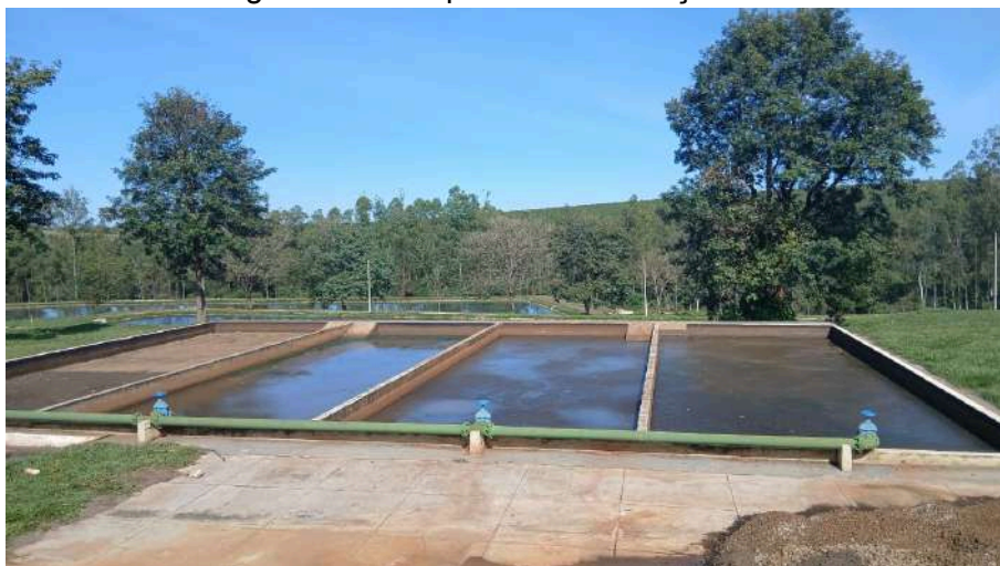
Figura 23 : Tanques de decantação.
