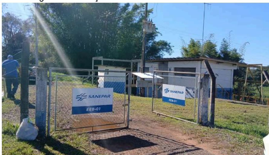
Figura 33 : Estação Elevatória de Bombeamento.
