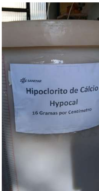
Figura 27 : Tanque de dosagem de hipoclorito de cálcio.
