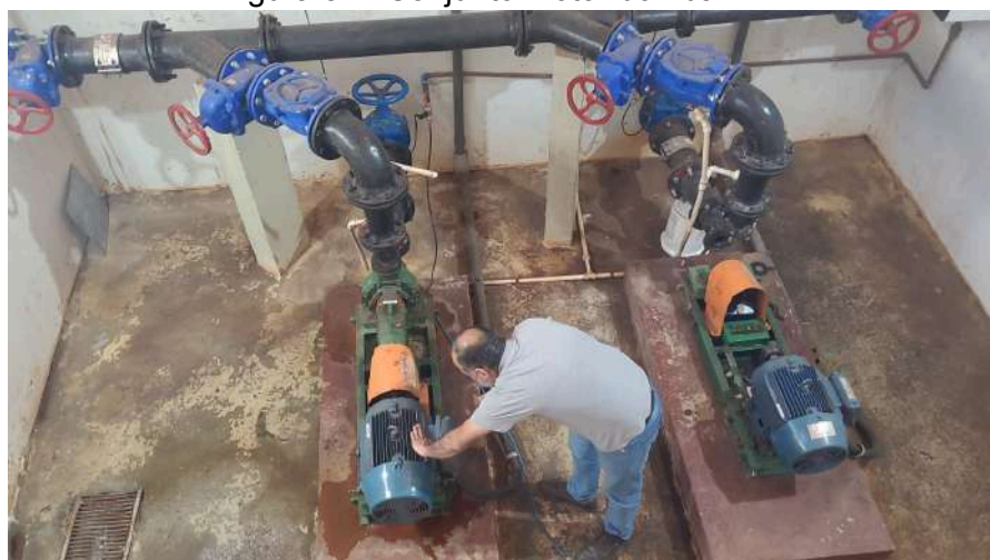
Figura 34 : Conjunto motor bomba.
