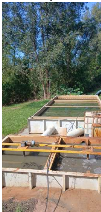
Figura 36 : Tanques de decantação.
