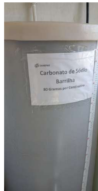
Figura 29 : Tanque de dosagem de carbonato de sódio.
