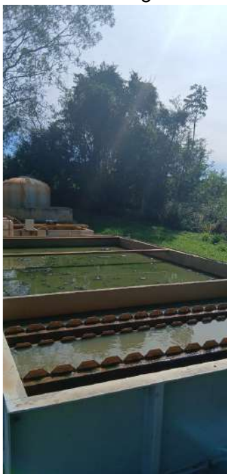
Figura 35 : Tanques para tratamento biológico.
