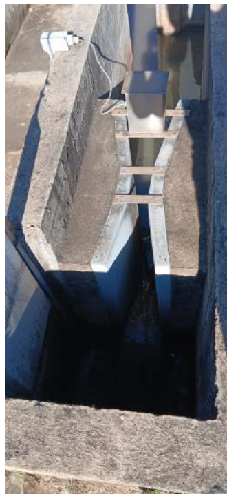
Figura 39 : Estrutura medidora de vazão.
