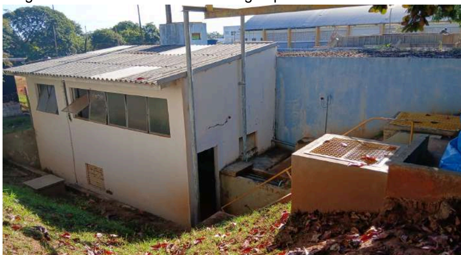
Figura 24 : Sistema elevatório de água para o reservatório.
