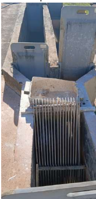
Figura 38 : Estrutura de gradeamento para tratamento preliminar.
